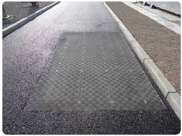
Tapas D400 instaladas en una carretera de acceso a la planta
