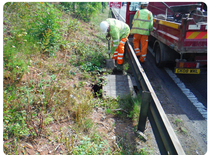
Las antiguas tapas pesadas eran un peligro para los trabajadores
