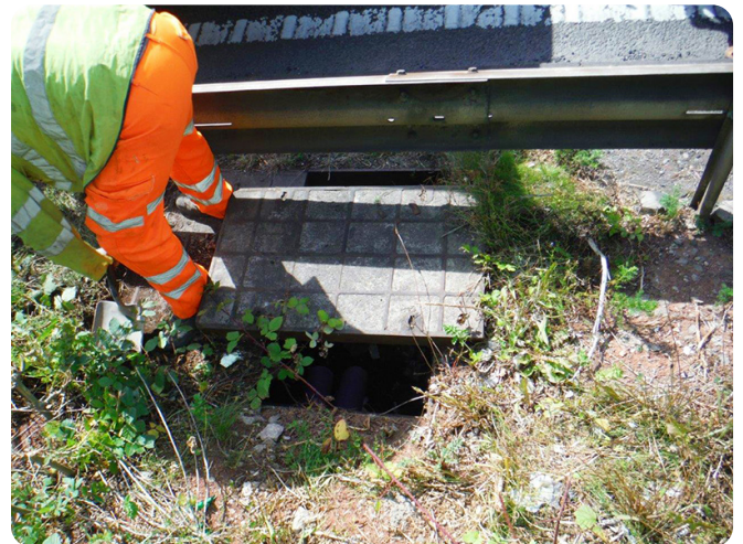
Tapas de hierro fundido y cemento deterioradas
