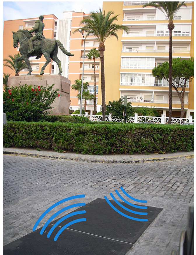
Las señales de radiofrecuencia traspasan libremente las tapas FM45 ya puestas en su sitio. Crédito de la foto: Aguas de Cádiz
