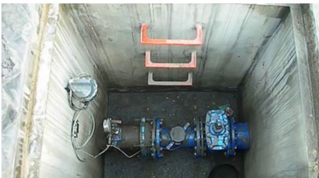
Sistema de control automático ubicado debajo de una tapa metálica que bloquea la señal. Crédito de la foto: Aguas de Cádiz
