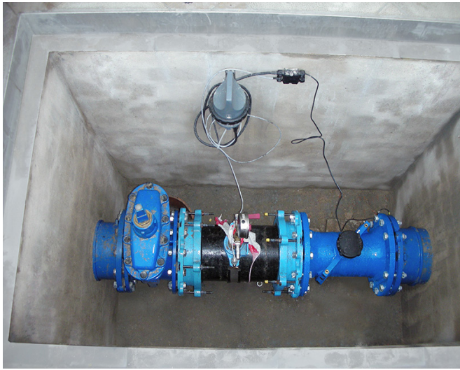
Sistema de control automático Crédito de la foto: Aguas de Cádiz
